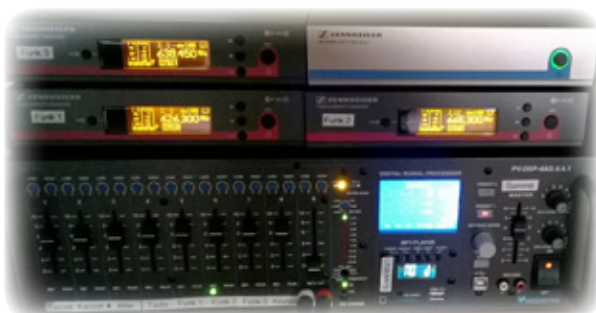
„Die neue Verstärker-Anlage in der Kreuzkirche“
